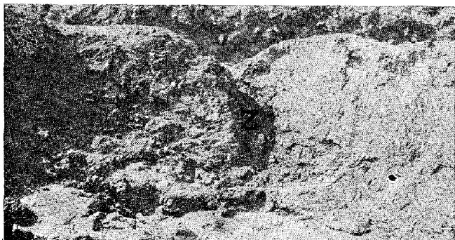
Рис. 41. Деталь: повреждение кольцевого корпуса печи в западной части.
